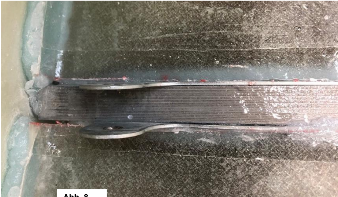
Abb 8 – in Seitenruder installierte Antriebsrippe mit deutlichem Spalt zwischen Beschlag und Holzrippe; (kann Wassereintritt begünstigen, siehe Bemerkung am Ende von Maßnahme A) rudder drive plate with considerable gap between drive plate and wooden rib installed in rudder; (may lead to water entry, see remark at the end of instruction A)
